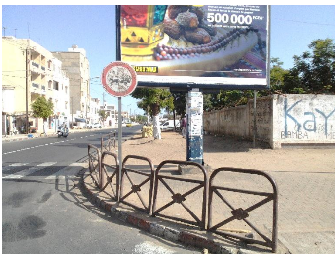
Photo 10 : Mur du Lycée Kennedy impacté
